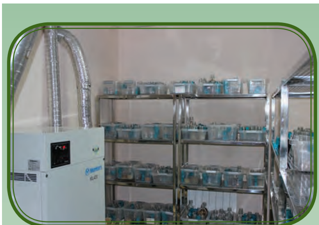
Сушильная комната, оборудованная системой Munters ML420
